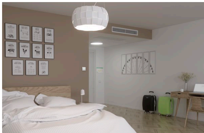
Habitación de hotel con selector del valor de consigna, refrigeración y calefacción por agua así como regulación del aire en función de la demanda. Lector de tarjeta-llave para ocupación.
